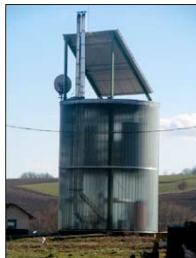
Nowoczesna kotłownia w adaptowanym starym majątku ziemskim
